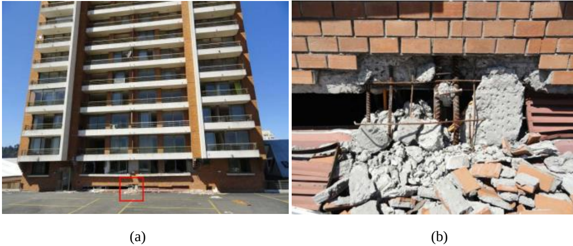
Figura 5.23 – Daño exterior cara norte reportado luego del terremoto de 2010, Alto Arauco [21].
