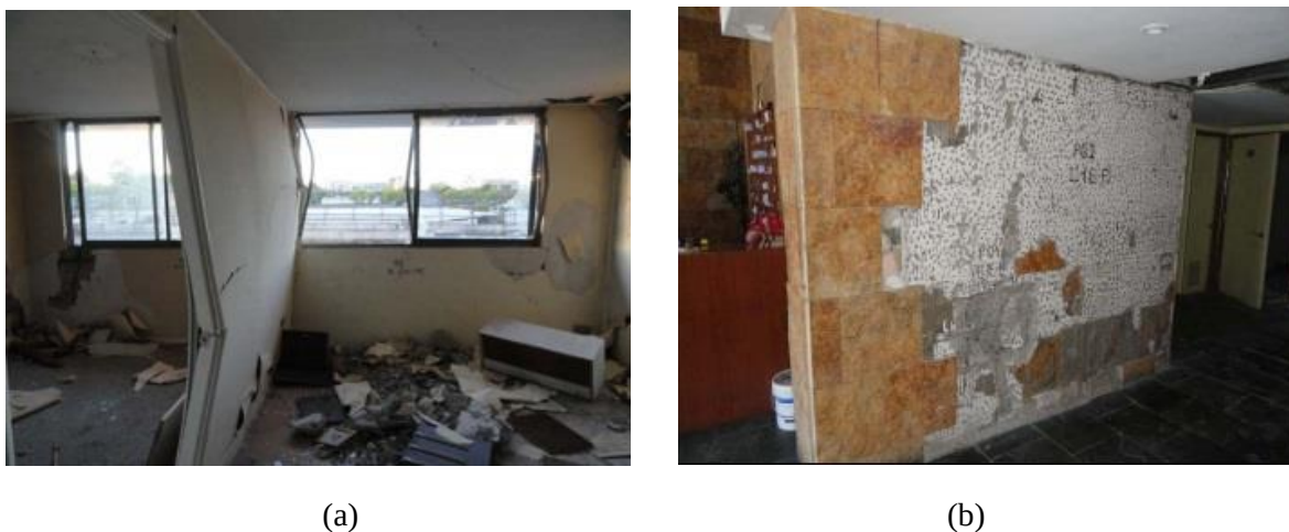
Figura 5.29 – Daño observado en elementos no estructurales en edificio Alto Arauco; a) Tabiquería divisora pandeada, b) desprendimiento de terminación de cerámica [21].
