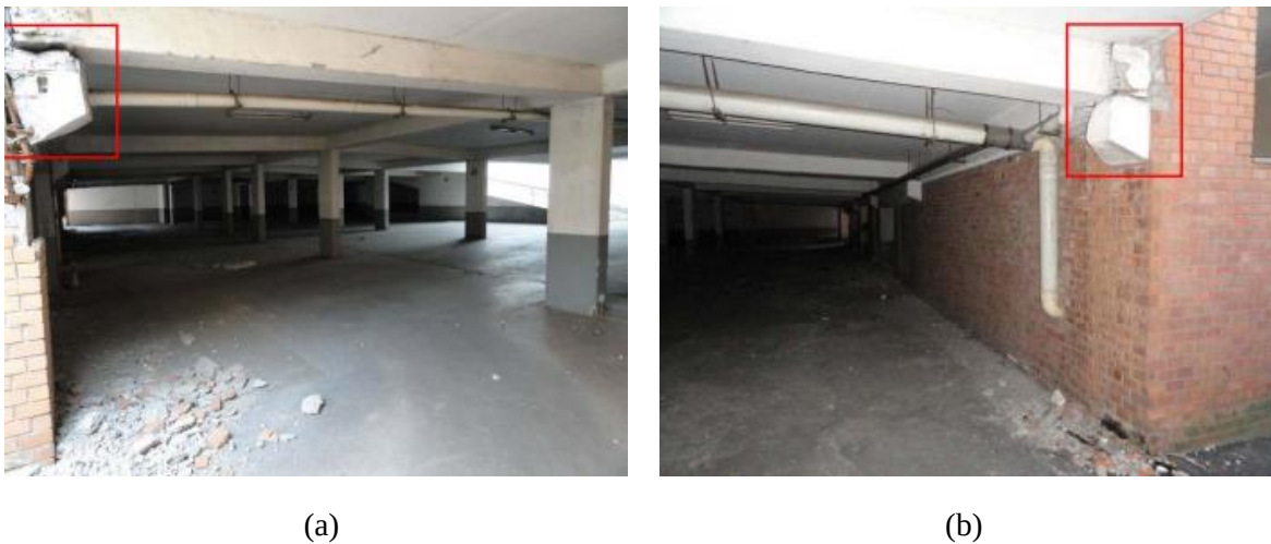
Figura 5.24 – Daño estacionamientos reportado luego del terremoto de 2010, Alto Arauco [21].
